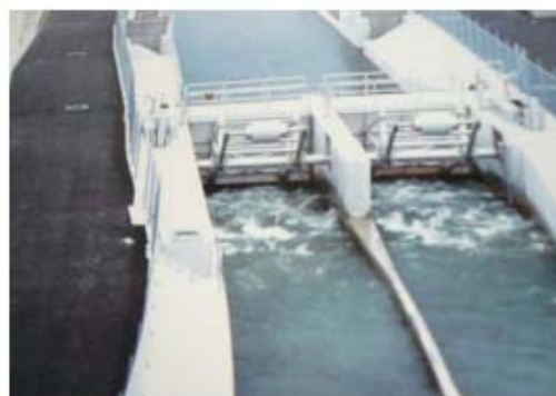
●幹線水路水位調節堰
